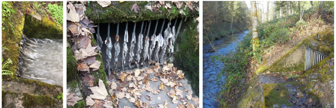
Abbildung 3: Auslauf Entlastung RÜB Sursee Wald. Die Sure wird stark verschmutzt.
